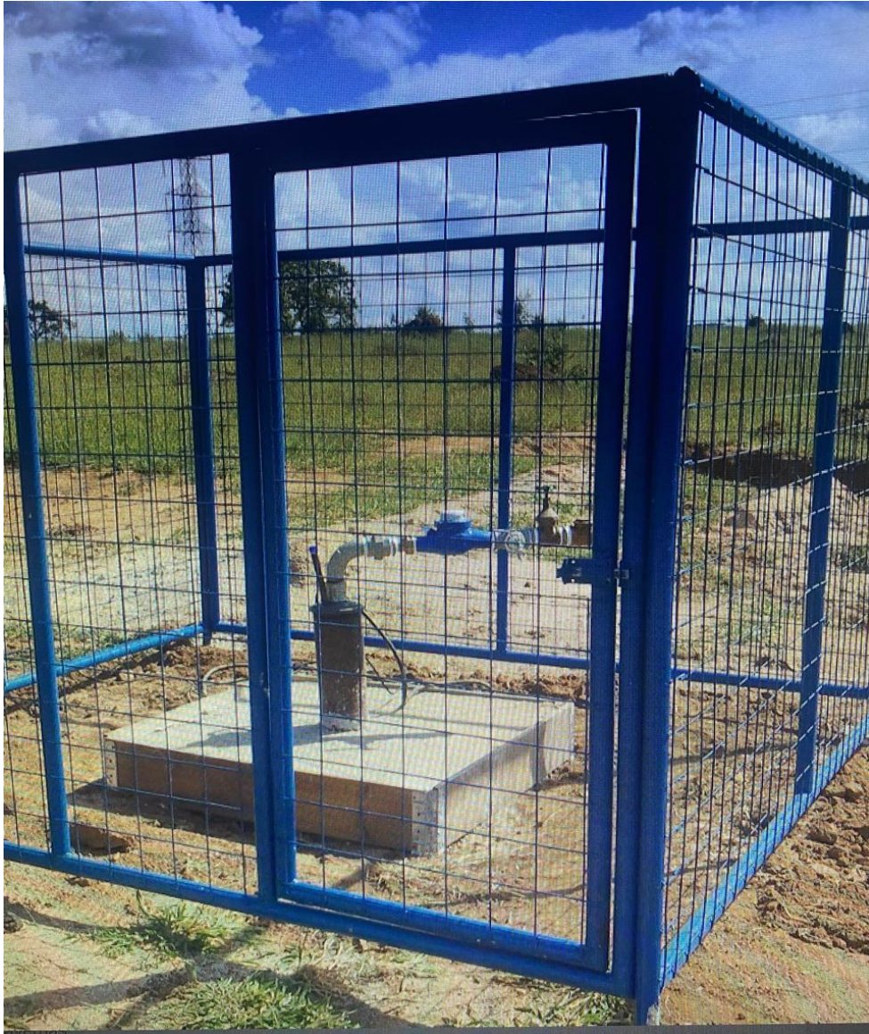
Foto 1- Imagem modelo da conclusão final da obra (perfuração e instalação) com cimentação da base, hidrômetro para medição do volume extraído, cano de medição de nível e cercado de proteção. Exigência da Secretaria de Meio Ambiente e Recursos Hídricos m- SEMAE.
